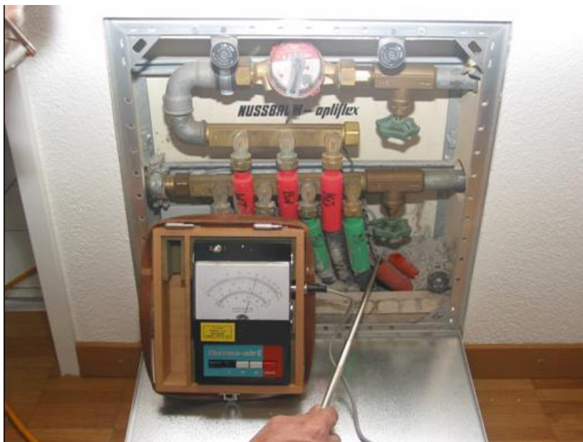
Figur 20: Kalt- und Warmwasserverteiler
