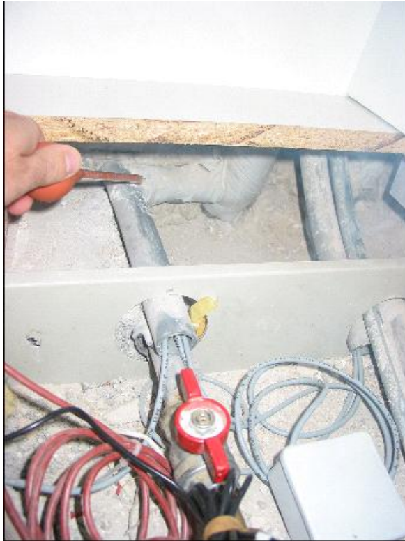
Figur 24: Heizungssteigzone und Bodenheizungsverteiler (vorne)
